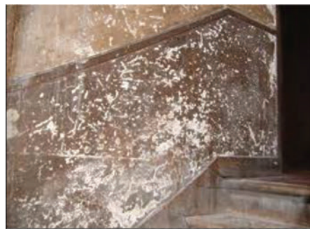
Les vieilles peintures en mauvais état sont particulièrement à risque
